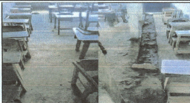
FOTOGRAFIA 1: Los niños de preprimaria reciben las clases en una bodega improvisada, la cual no tiene las dimensiones correctas para el uso que se le da, creando incomodidad para el proceso de enseñanza y aprendizaje.
